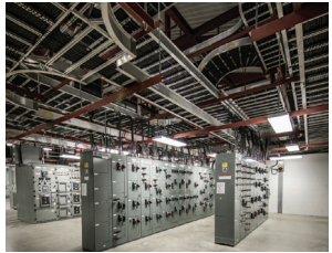
Tioga Gas Plant
